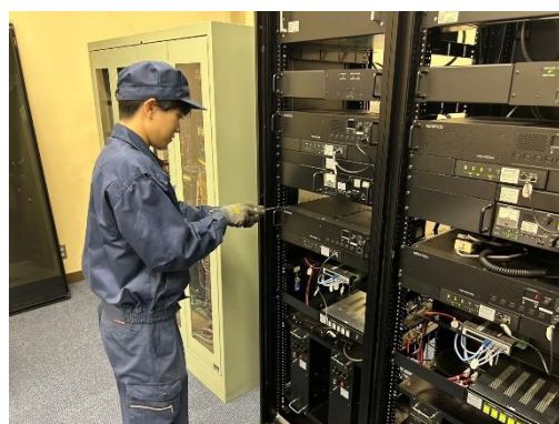
通信設備の点検
