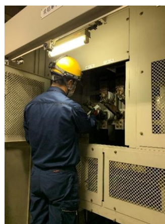
変電所設備の点検
