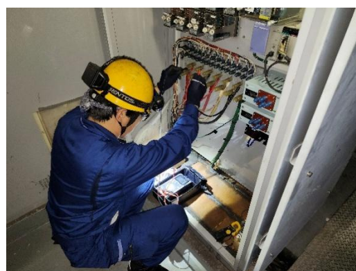
ギヤモーター取替後の電圧測定
