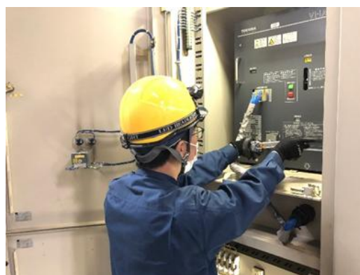
変電所設備の点検
