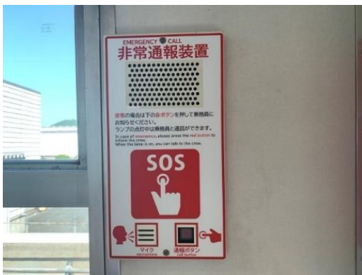
非常通報装置
