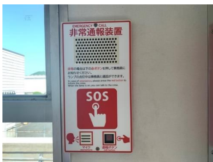
非常通報装置
