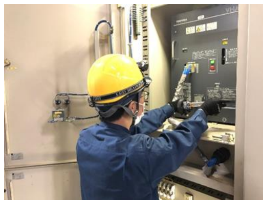
変電設備の点検
