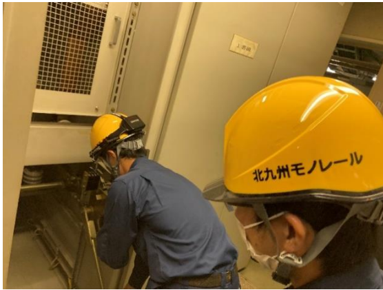
き電区分開閉器取扱訓練
