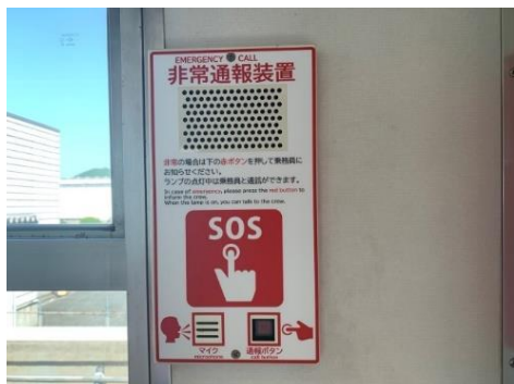
各客室に設置しています
