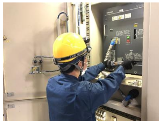
変電所設備の点検
