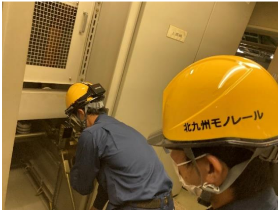
き電区分開閉器取扱訓練
