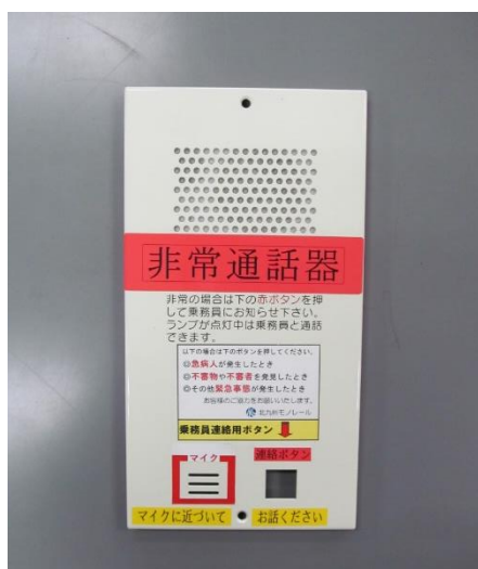
各客室に設置しています
