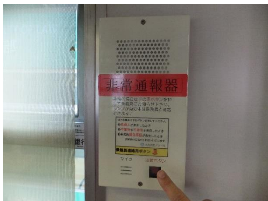
各客室に設置しています
