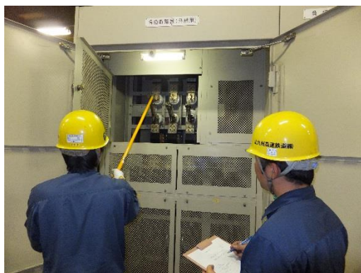
変電所設備の点検
